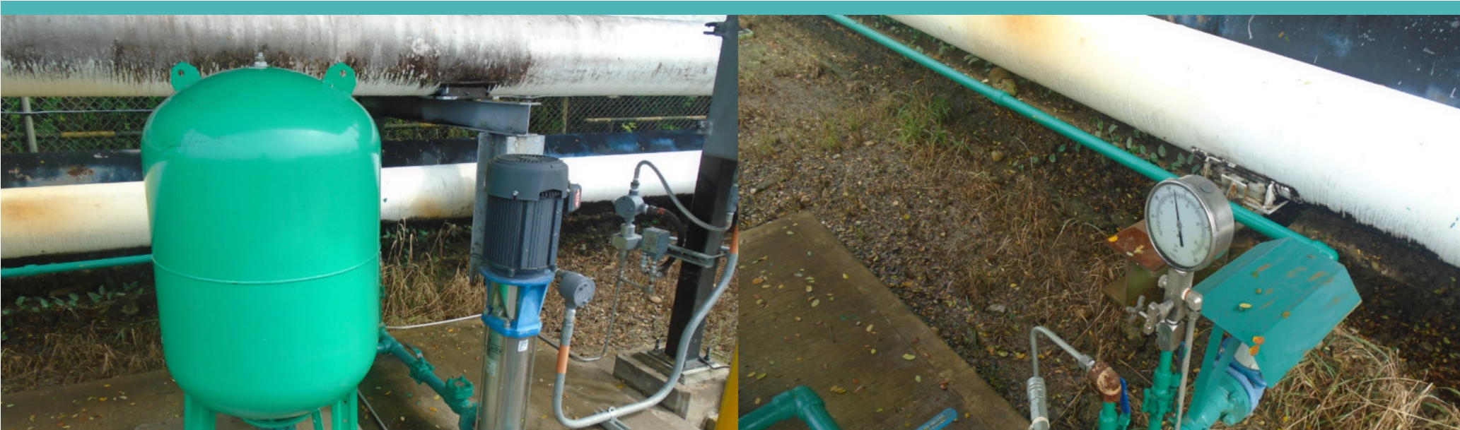
Sistema de Reutilización de Aguas Lluvias para uso industrial, provenientes del drenaje de los tanques, Estación Vasconia.
